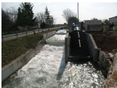
Un impianto micro-idroelettrico
